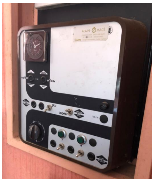
Ancien coffret électrique (50 ans)
