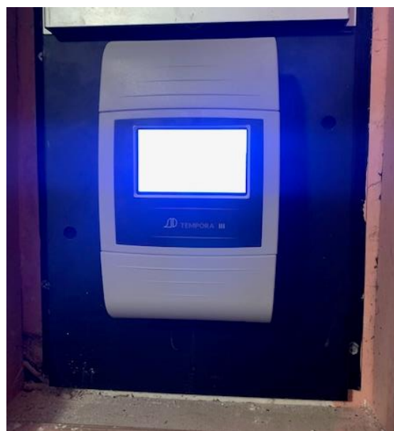
Nouveau coffret électrique
